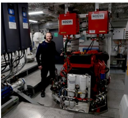
MASKINEN: Maskinsjef Sverre Martinsen ved en av motorene i maskinrommet til «MF Smøla».
