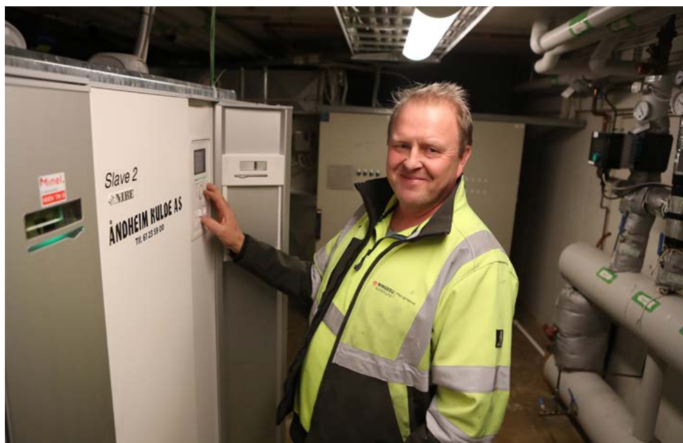
Geir Bråten ved varmeanlegget i det tekniske rommet i kjelleren til ungdomsskolen.
